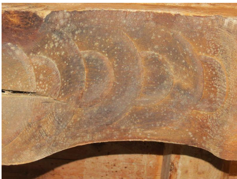
Projevy napadení plísněmi (bílé skvrny na dřevěných plochách v interiéru) – analýza vzorků stěrů TZÚ Brno, 2020
